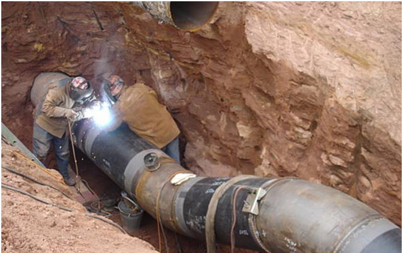
Schweißen einer Erdgasleitung mit einer Nennweite von 600 Millimeter bei den Bauarbeiten im Bereich des Flughafens Ramstein
